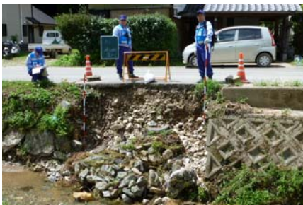
河川護岸の被災調査
