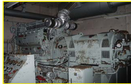
非常用発電設備の被災状況
